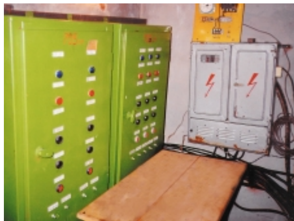
Контролируемый пункт системы телемеханики линейного участка нефтепровода
