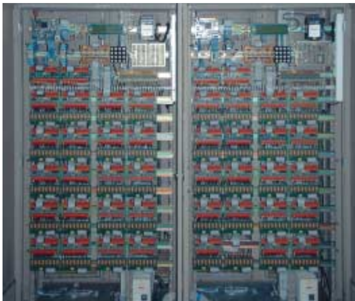
Рис. 4. Шкафы подсистемы ввода сигналов системы управления (ПВССУ)
