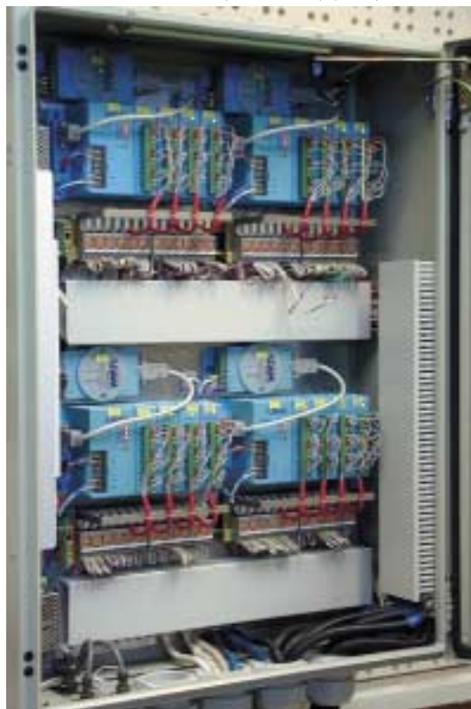
Рис. 5. Один из шкафов с оборудованием подсистемы ввода сигналов от датчиков температуры (ПВСДТ)
