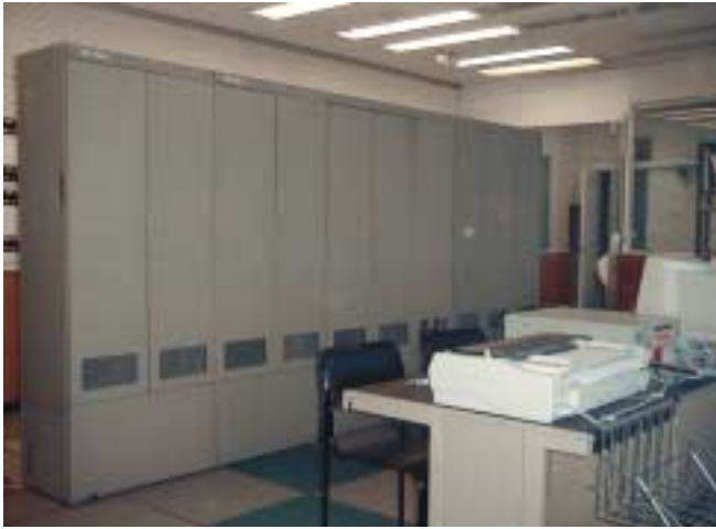
Рис. 2. Шкафы с аппаратурой ПВДС и ПВССУ
