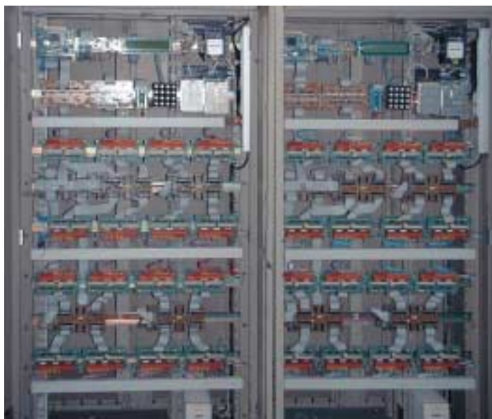
Рис. 3. Шкафы подсистемы ввода дискретных сигналов (ПВД)
