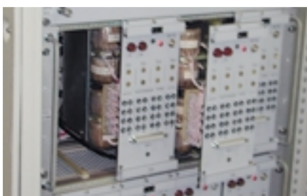
Рис. 7. Блоки БФ в стойке аппаратуры ФМ-канала
