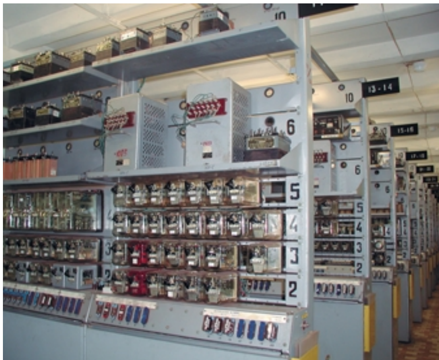
Рис. 2. Общий вид помещения АДП (аппаратуры телемеханики и управления движением поездов) со старым оборудованием (зона ответственности — около 500 м пути в пределах станции и 3 стрелки)
